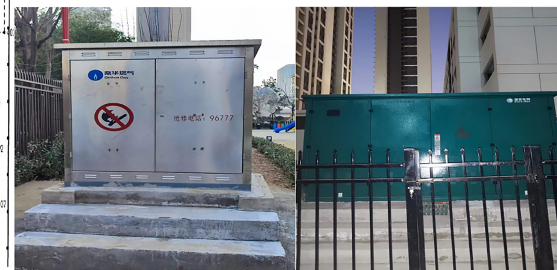
3、天然气调压箱 4、环网柜
